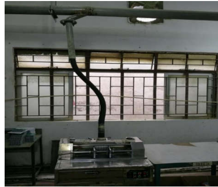
成型工序废气收集管道
