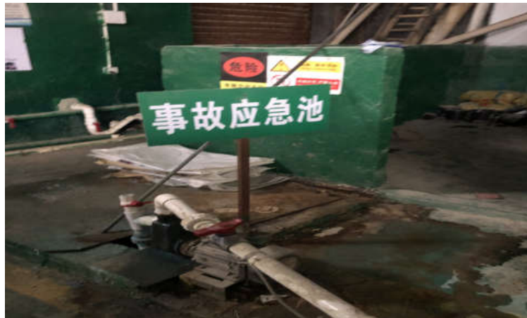
图 2-18 厂区内地下式事故应急池
