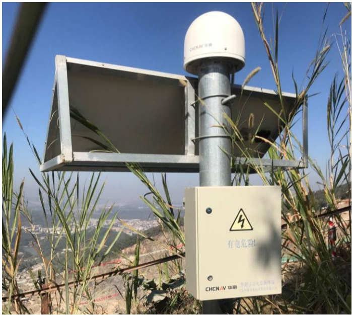
图 2.4-1 边坡监控自动化措施
