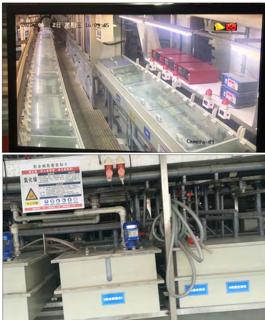
图 4.3-1 全自动生产线的废气全包式收集措施
