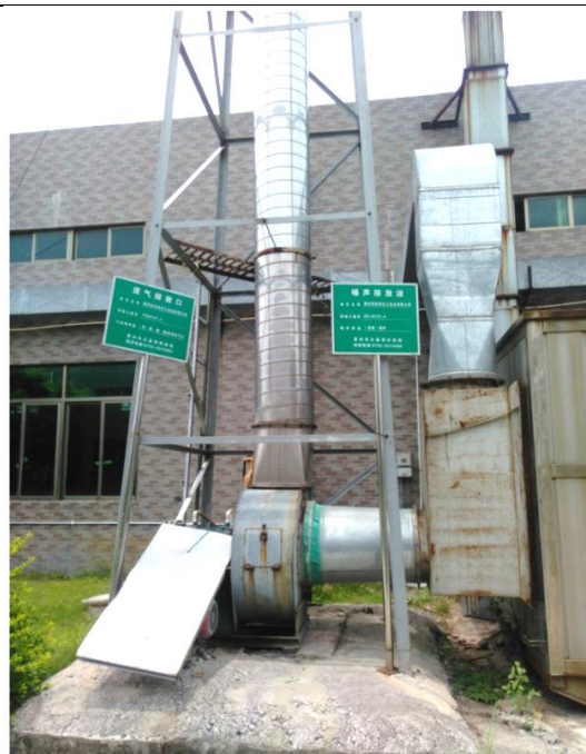
B4#甲类车间废气治理设施
