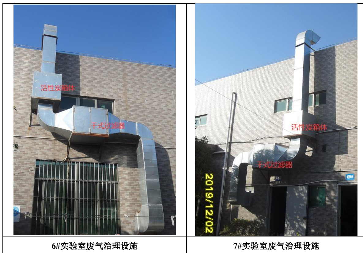
图 3.10-2 废气治理措施现状
