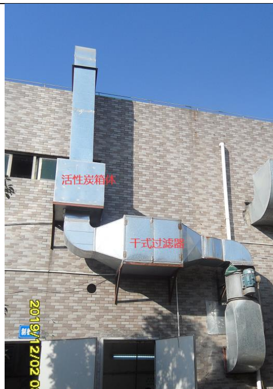
3#实验室废气治理设施
