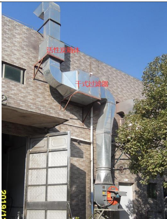
4#实验室废气治理设施
