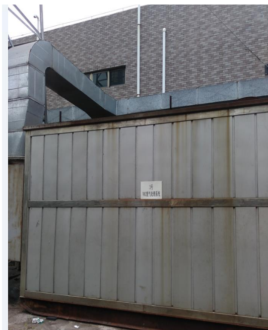
B3#甲类车间废气治理设施
