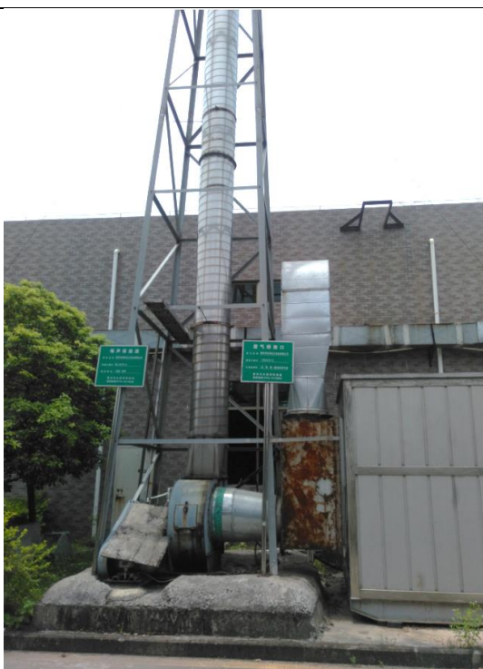
B5#甲类车间废气治理设施
