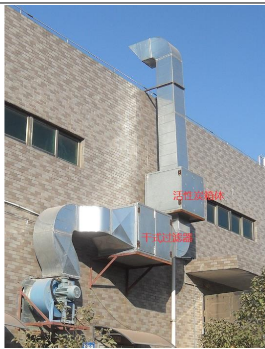
5#实验室废气治理设施
