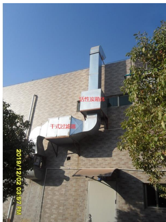
1#实验室废气治理设施
