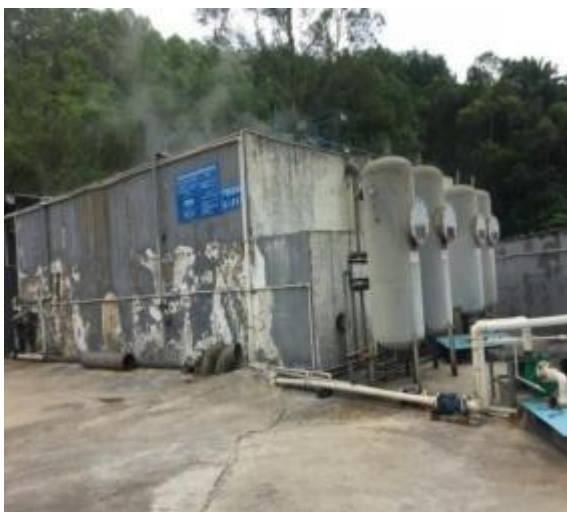
现有项目自建废水处理站
