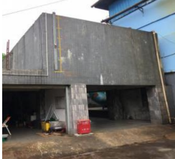
现有项目碱液池
