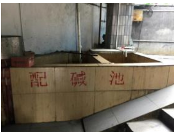
现有项目配碱液池
