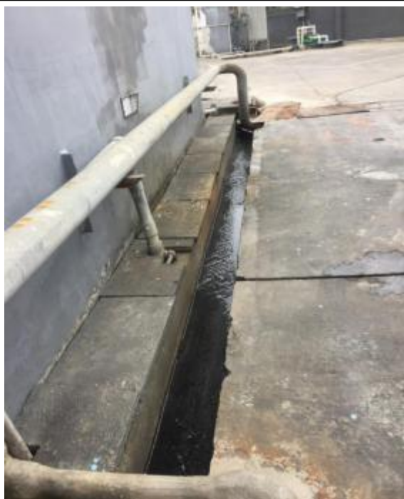
现有项目废水收集明沟
