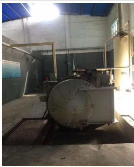
现有项目高温蒸煮炉
